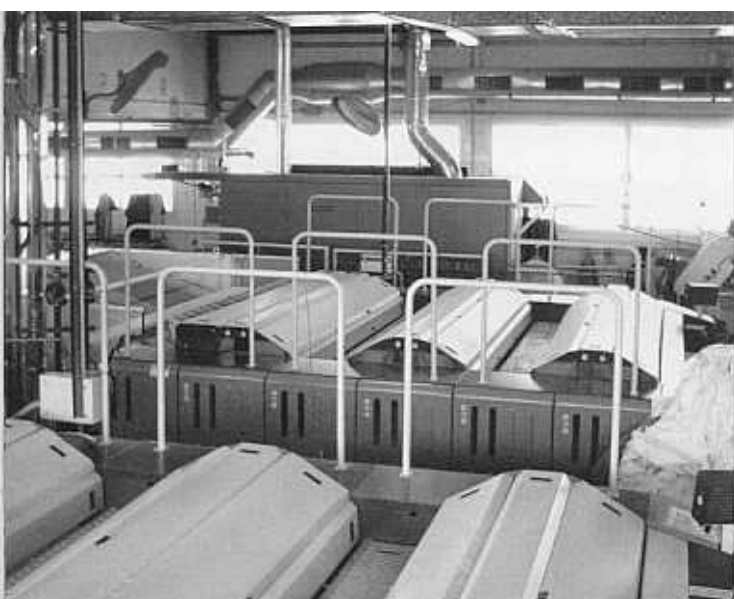
Zona de planchado de la lavandería.
