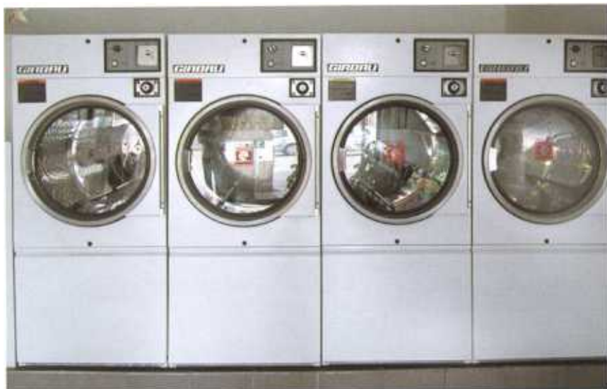
Secadores STI-12 de Girbau instalados en el camping.
